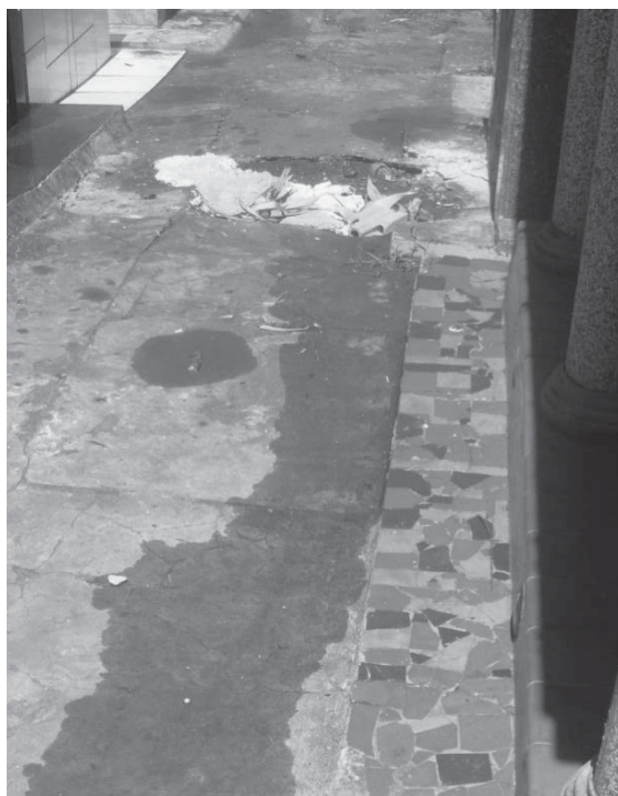
Figura 07: Água escoando até infiltrar no solo exposto. Foto: ARFELLI,2010.
