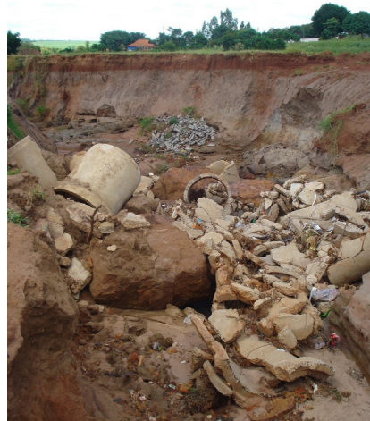
Figura 13. Resultado da tentativa de desviar as águas das chuvas por tubos. Fotografia registrada em 16 de março de 2010.
