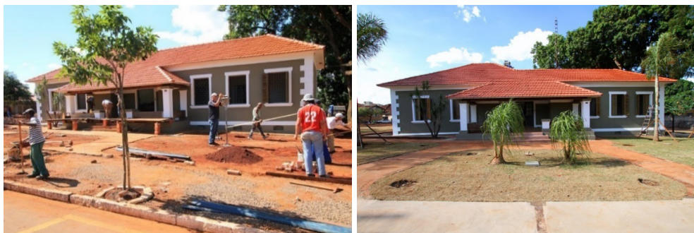
Figura 22. Casa da antiga Companhia Estrada de Ferro São Paulo-Paraná. Membros da Secretaria Municipal de Obras concentrados na fase final de restauração do imóvel. Ano: 2013.
